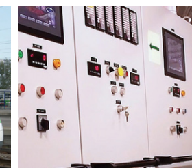
Sähkölaitteet ja -järjestelmät
