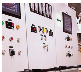
Sähkölaitteet ja -järjestelmät
